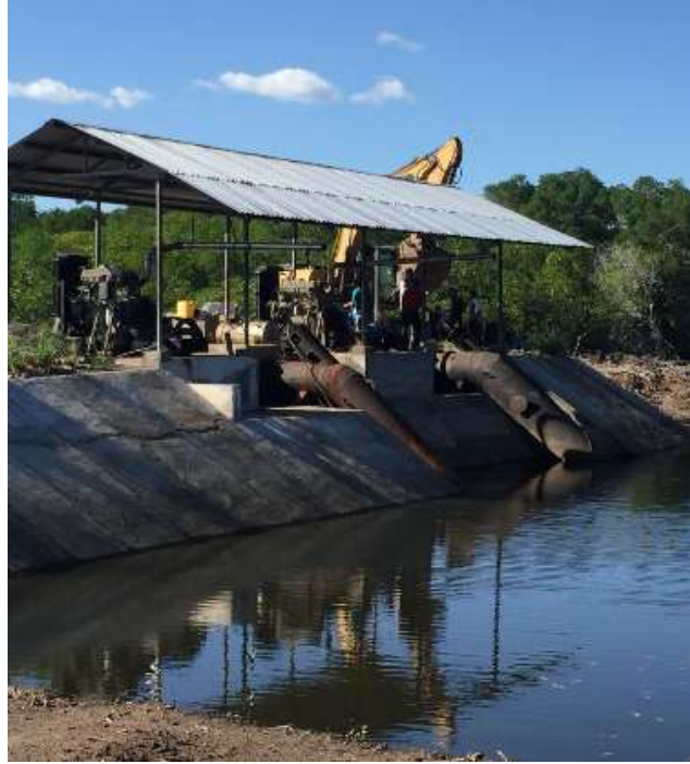
Figura 21. Estación con bombas axiales estacionarias.
