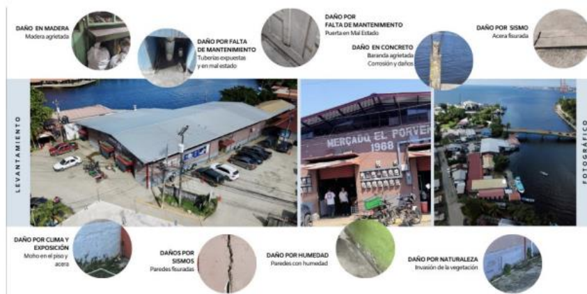
Figura 2 Análisis de daños del Mercado “El Porvenir”.
