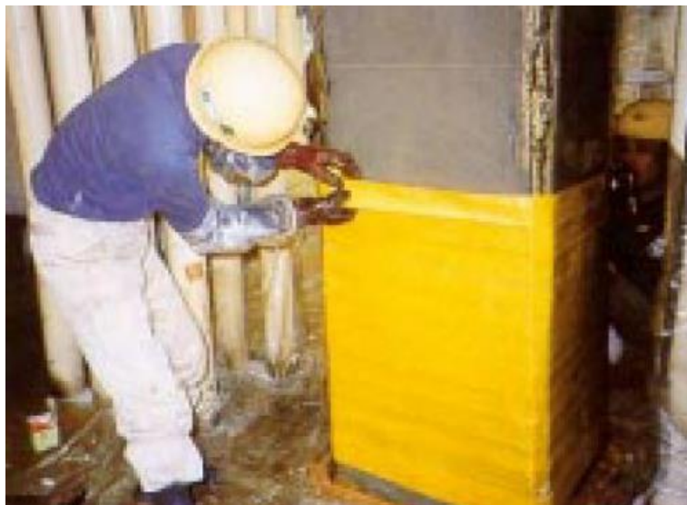
Ilustración 9 Pilar de puente reforzado con AFRP
