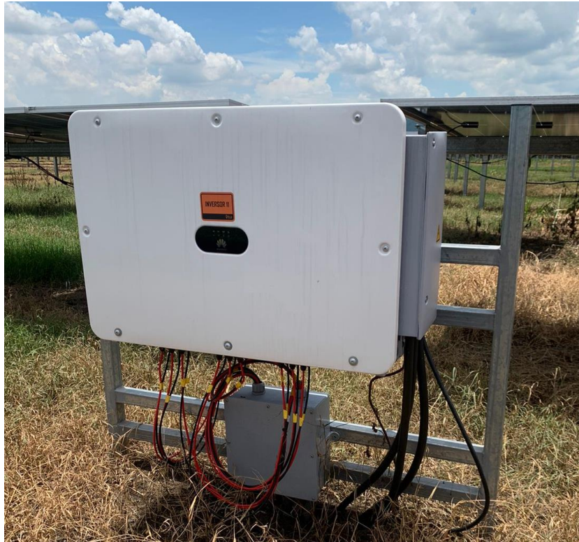
Ilustración 25 -Inversor solar utilizado en la planta de generación de energía.
