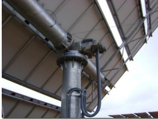
Ilustración 5 – Vista de cerca sobre el eje de doble que sostiene una sección de paneles en el parque Lasesa II.
