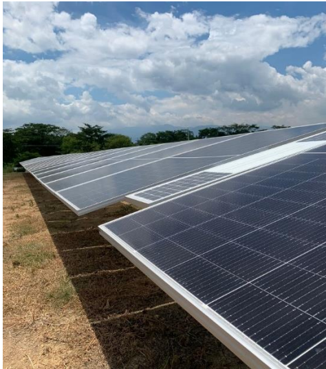
Ilustración 24 -Segmento de una mesa de paneles solares.
