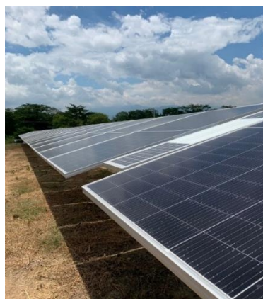
Ilustración 7 -Segmento de una mesa de paneles solares.
