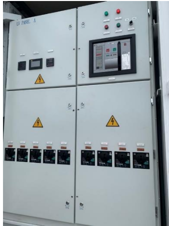
Ilustración 8 – Panel de distribución del transformador.
