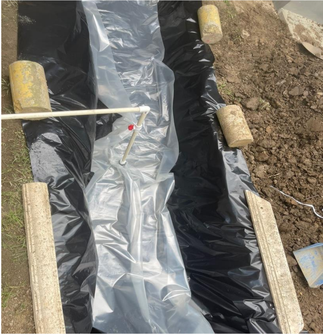
Ilustración 32 Biodigestor Instalado sin Mezcla Dentro Fuente: Elaboración propia
