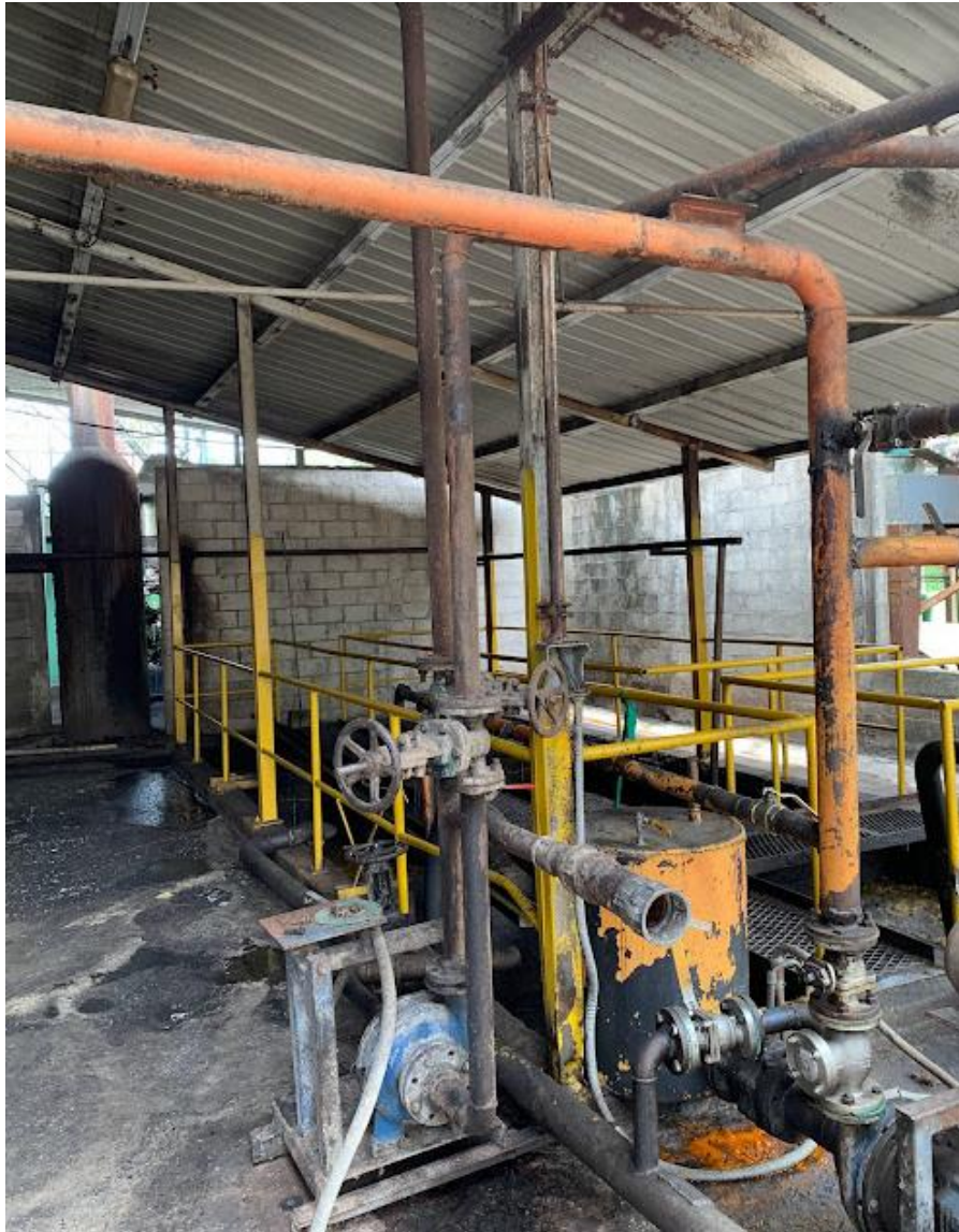
Ilustración 31 Sistema de conducción de efluente en planta de ACP en Honduras
