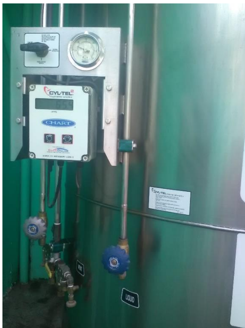
Ilustración 36. Revisión de volumen en tanque de oxígeno
