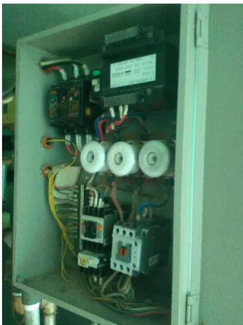
Ilustración 54. Fusible y contactor de autoclave
