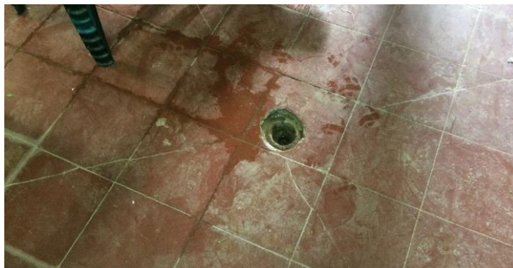
Ilustración 92. Piso de laboratorio en mal estado.
