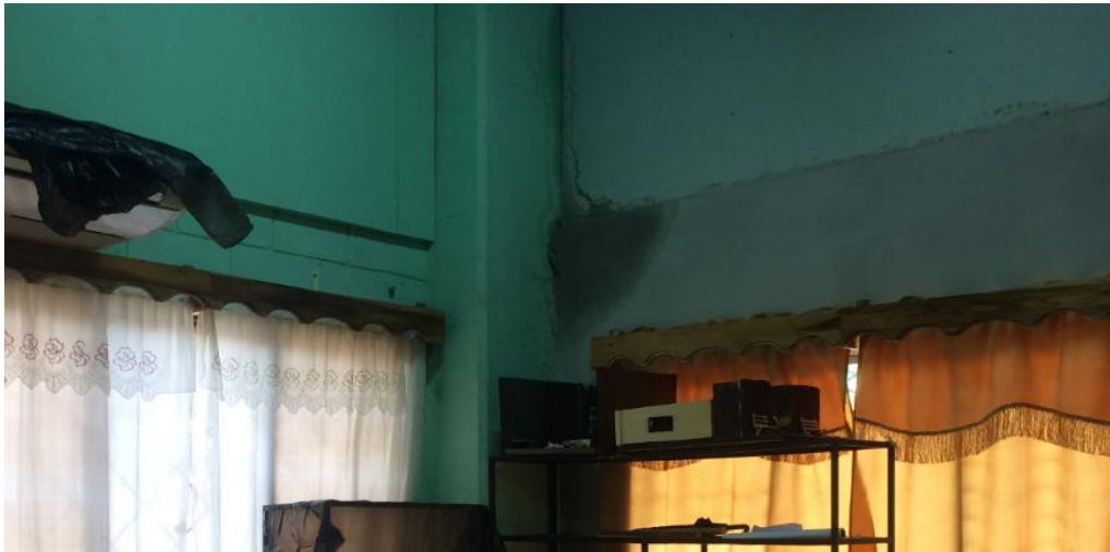
Ilustración 90. Daños en paredes por humedad.
