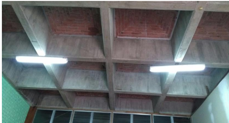
Ilustración 91. Estado actual del techo utilizado en aulas.
