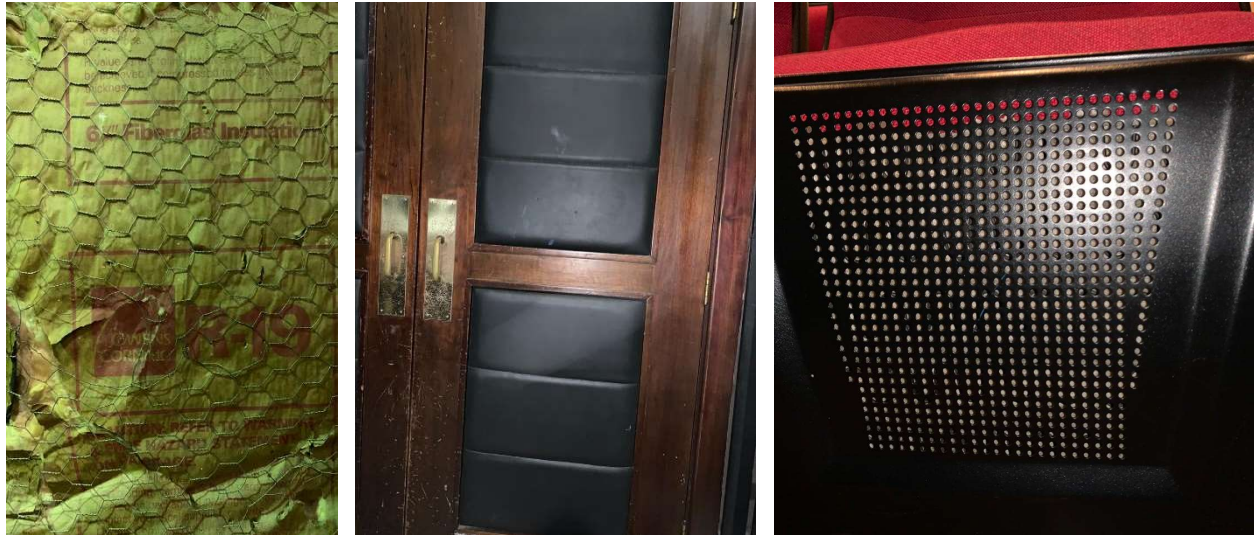
Ilustración 49. Materiales acústicos aplicados.
