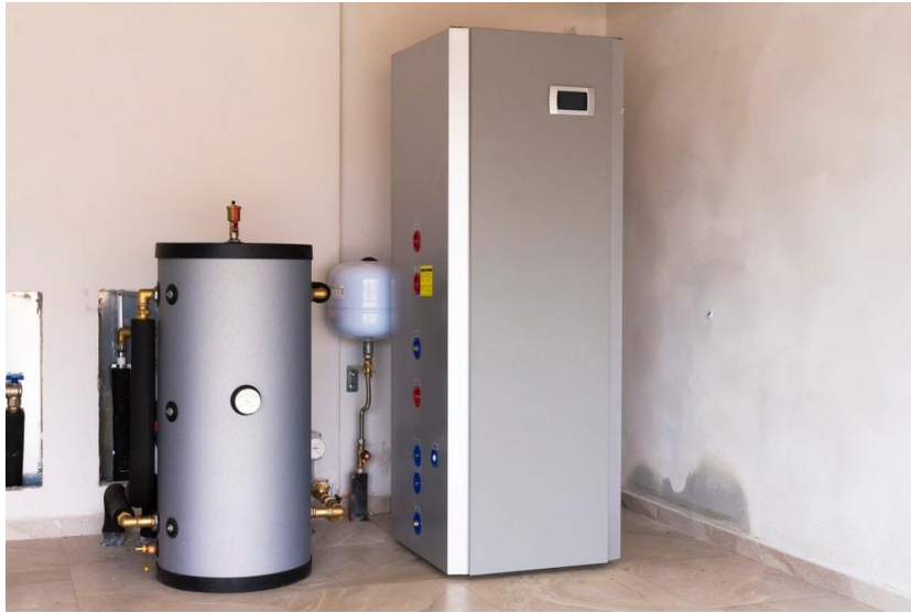
Figura 30 Bomba de calor agua-aire
