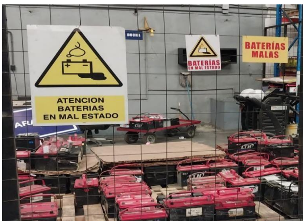
Figura VIII.11 Señalización de Baterías Malas
