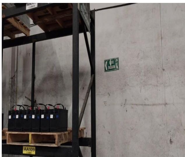
Figura VIII.4 Señalización de evacuación
