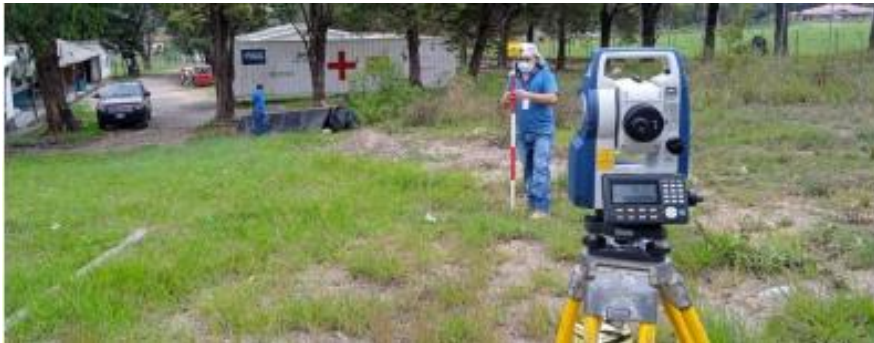
Ilustración 28 Dispositivo estación total
