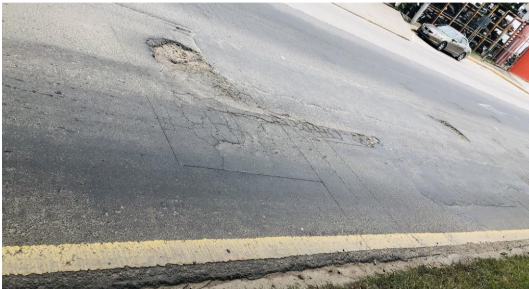
Ilustración 56 Falla en la estación 0+300
