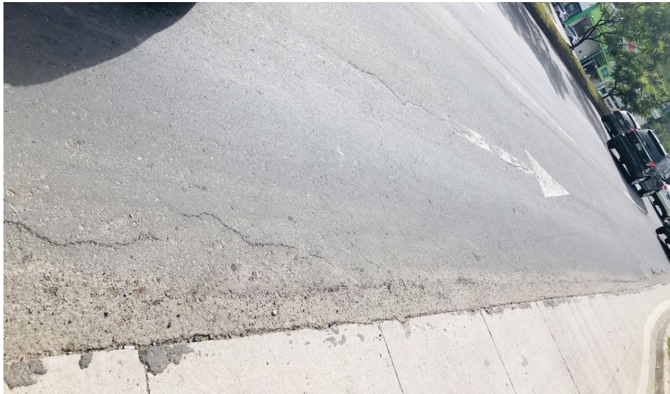
Ilustración 52 - Falla en la estación 0+075
