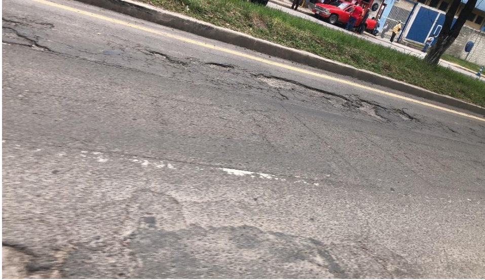
Ilustración 51 - Falla en la estación 0+050
