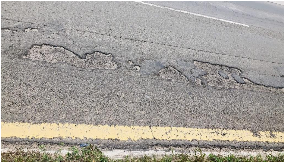
Ilustración 54 - Falla en la estación 0+210
