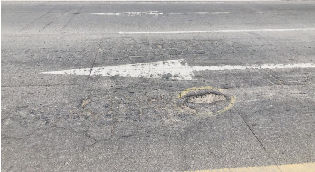
Ilustración 55 - Falla en la estación 0+250
