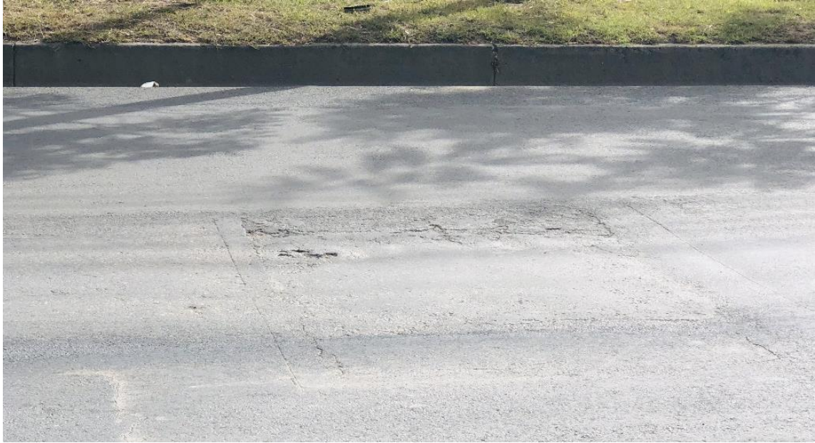
Ilustración 53 - Falla en la estación 0+150
