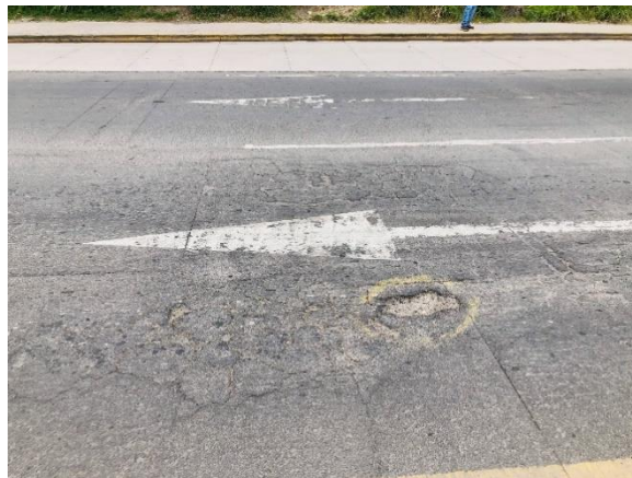
Ilustración 48 Fallas localizadas en el tramo
