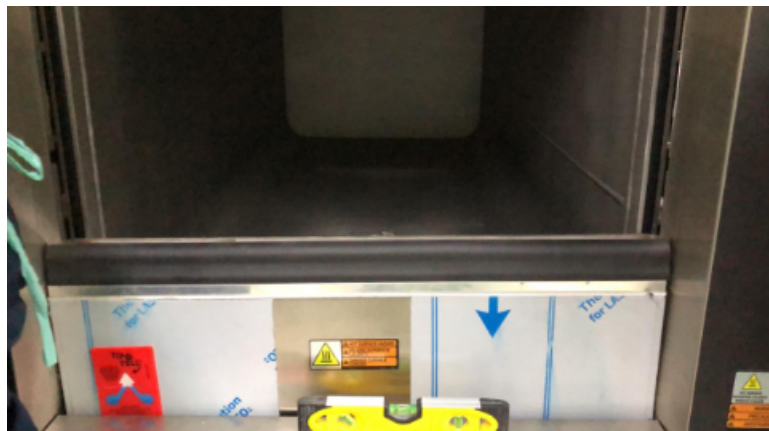
Ilustración 41 - Desnivel de la puerta
