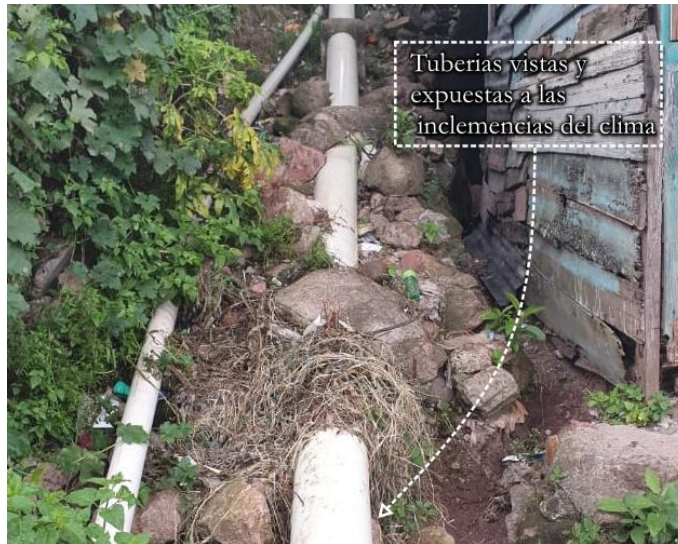
Ilustración 7. Tubería vista, expuesta a ser dañada fácilmente.
