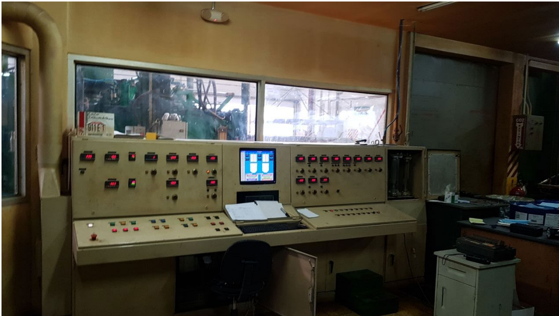
Ilustración 37 - Estación de Control Con VFD Malo
