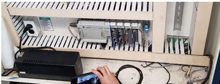
Ilustración 44 - PLC Allen - Bradley a Evaluar
