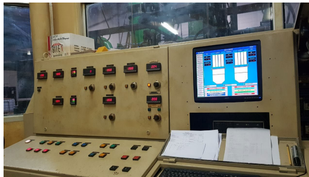
Ilustración 7 - Unidad Terminal Maestra en Fabrica de Camas
