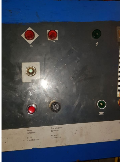
Ilustración 30 - Panel Operador Principal
