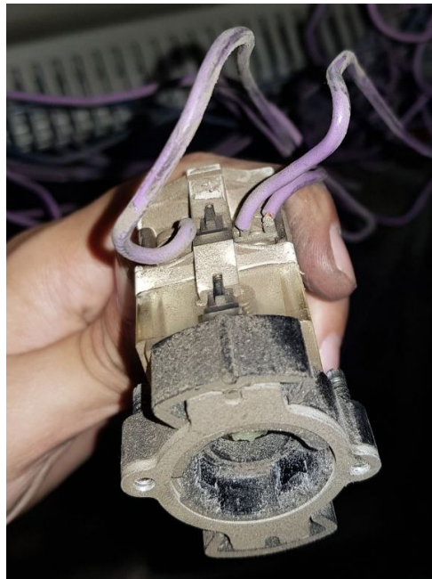
Ilustración 29 - Daño de Pulsadores Iluminados
