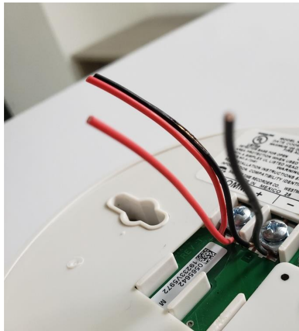
Ilustración 21: Cables sin recubrimiento en sensores de humo
