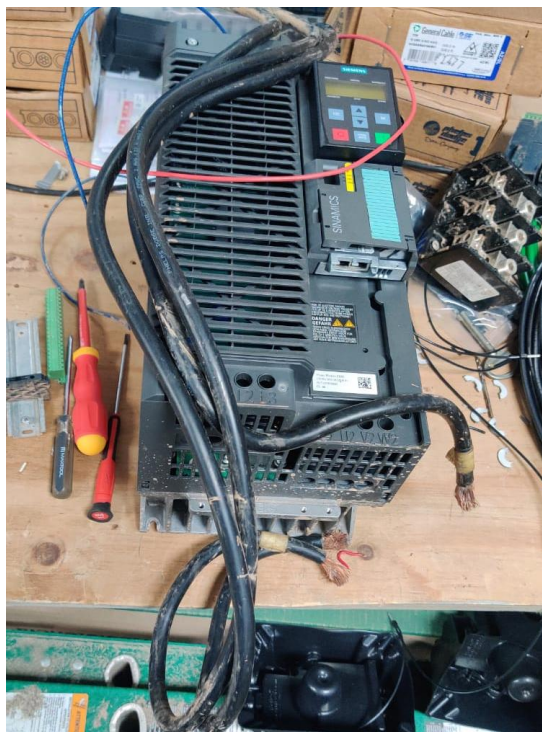
Ilustración 18-Variador de frecuencia afectado por las inundaciones
