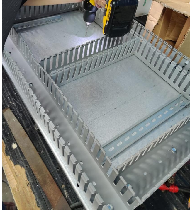
Ilustración 29-Estructura de panel de control
