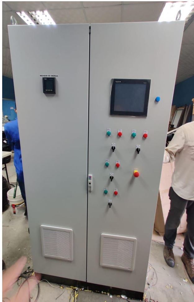
Ilustración 27-Panel de control grande finalizado
