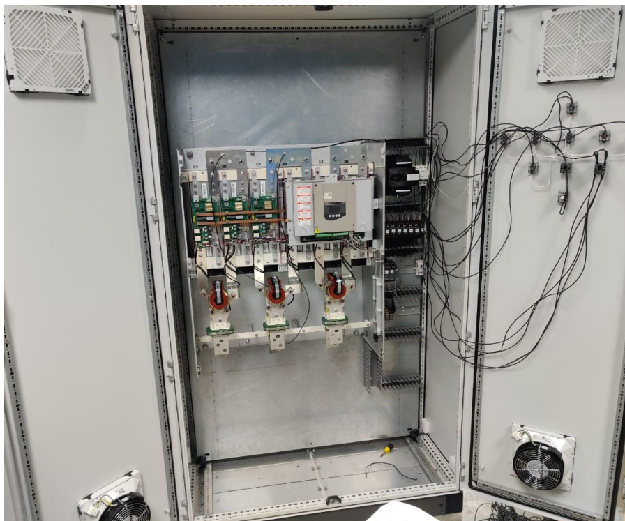
Ilustración 31-Panel de control para suavizar arranque del motor de 350 HP
