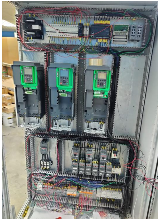
Ilustración 24-Montaje de variadores de frecuencia
