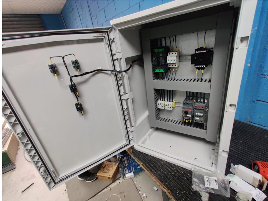
Ilustración 32-Panel de control para bomba de 7.5 HP
