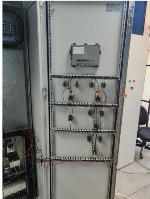
Ilustración 25-Montaje HMI y luces en la puerta del panel de control
