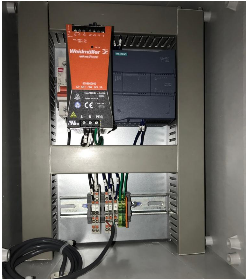
Ilustración 25. Gabinete o Panel de Control
