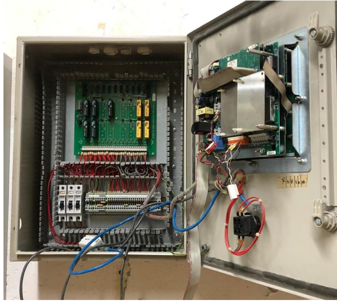
Ilustración 21. Conexión de controlador GSE
