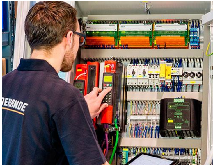
Ilustración 3. Mantenimiento Preventivo (Inspección de conexiones eléctricas)
