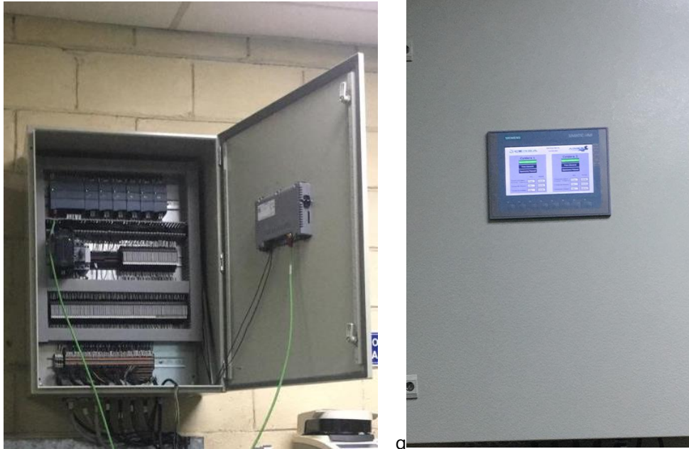
ILUSTRACION 19. PANEL DE CONTROL INSTALADO JUNTO CON KTP700
