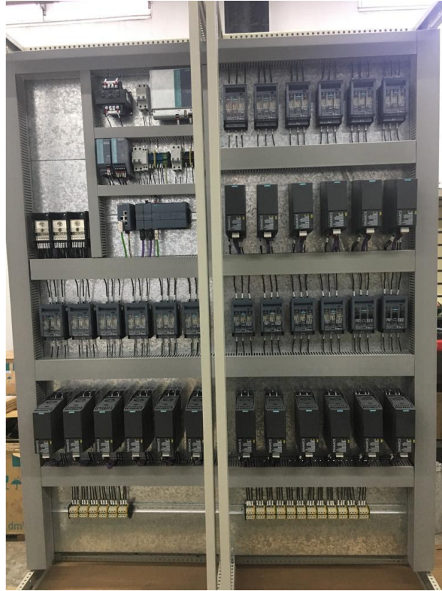
ILUSTRACIÓN 31. CELDA DE CONTROL, GILDAN
