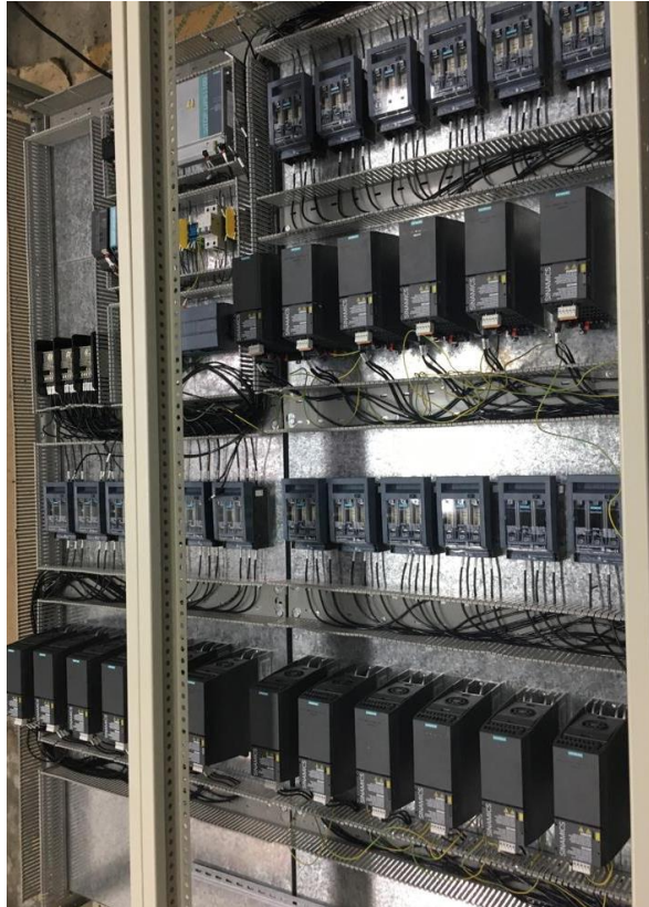
ILUSTRACION 25. CABLEADO DE CELDAS GILDAN
