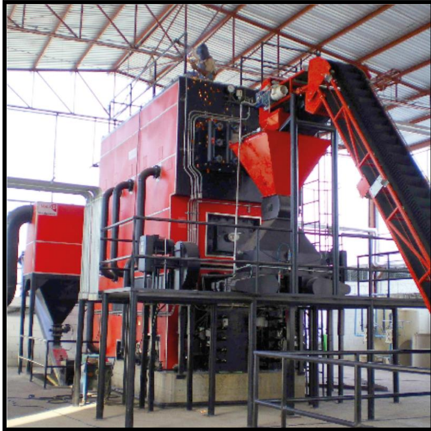
Ilustración 5 - Caldera de Biomasa en Alcon
