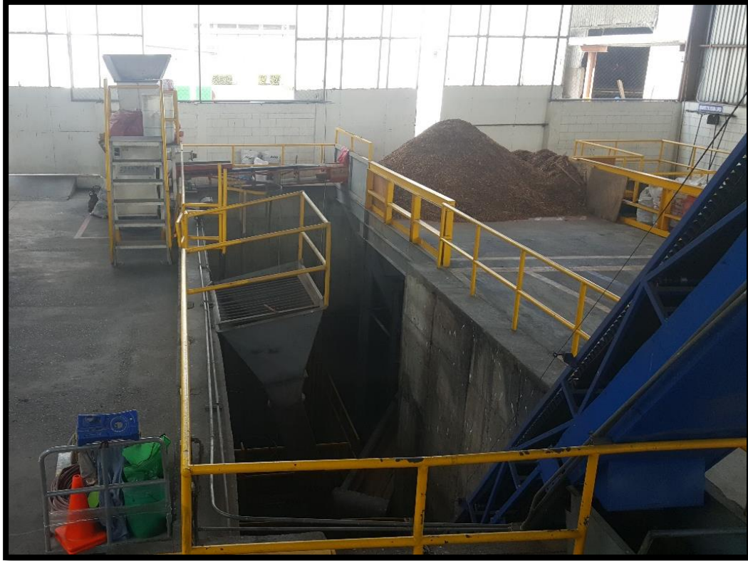
Ilustración 7 - Sistema Automático de Alimentación de Biomasa
