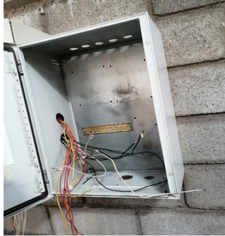
Ilustración 11. Gabinete eléctrico de control proyecto de recuperación de fino
