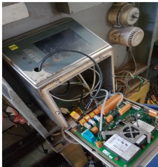
Ilustración 17. Mantenimiento eléctrico detector de metales
