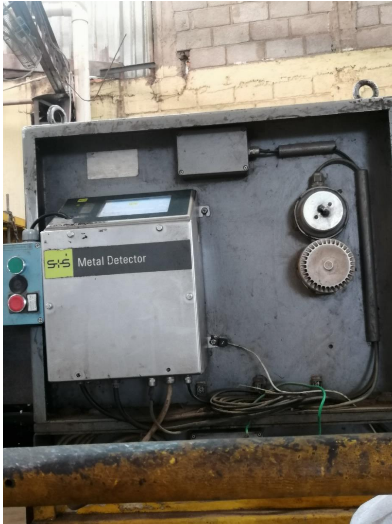
Ilustración 19. Detector de metales con control de reset híbrido instalado
