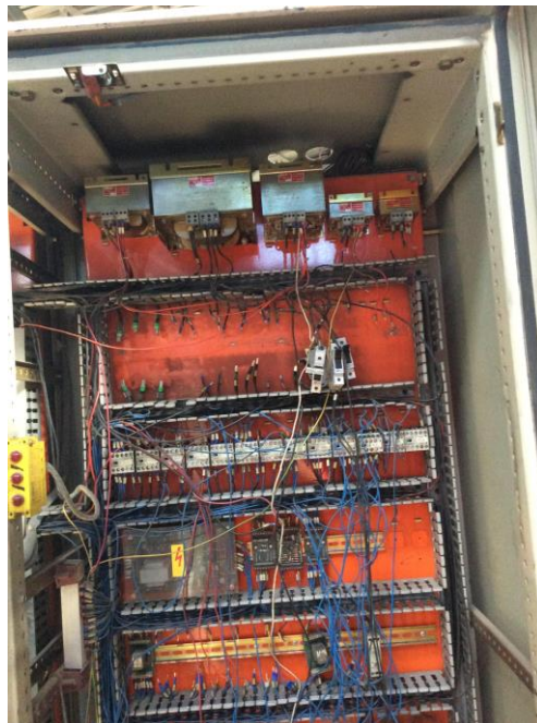
Ilustración 23. Gabinete eléctrico antes de desmontaje y limpieza
