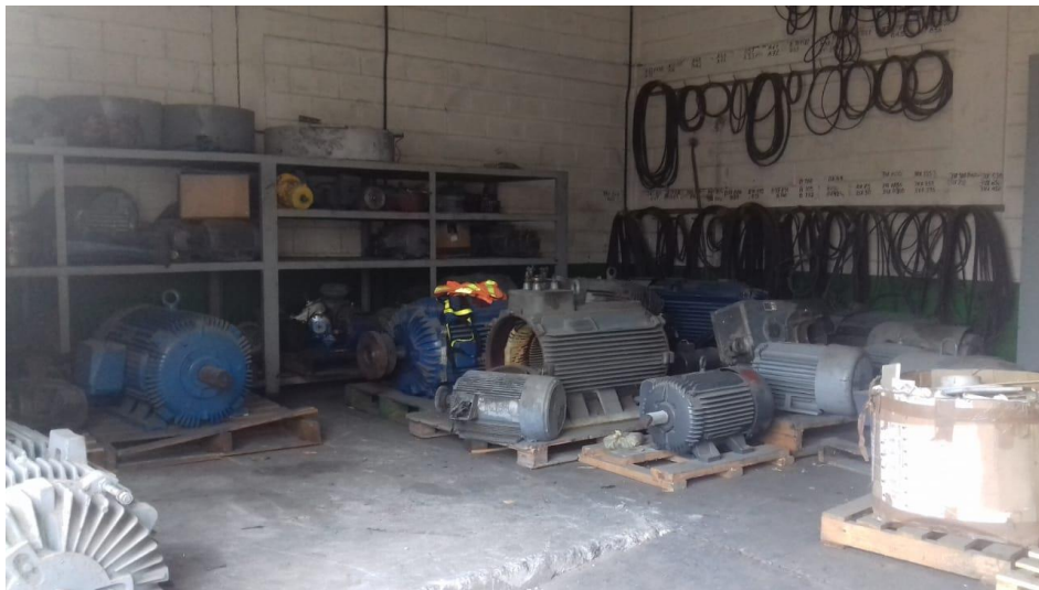
Ilustración 46 Cuarto de motores ordenado y clasificado.
