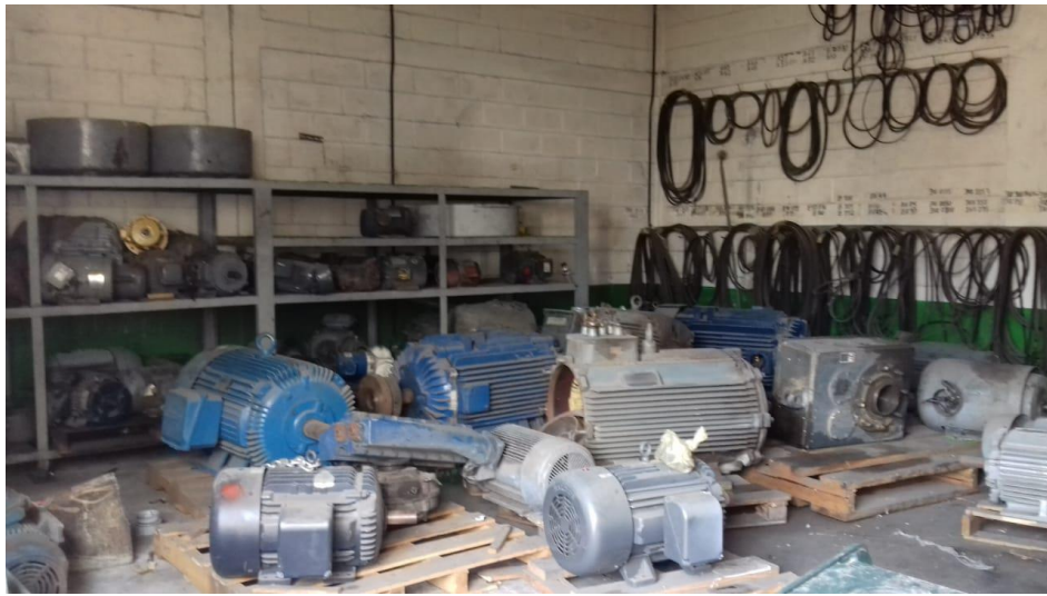
Ilustración 45 Cuarto de motores.
