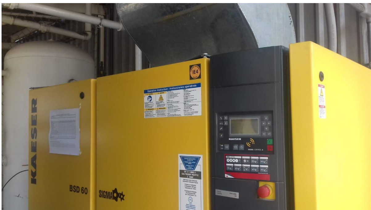
Ilustración 32 Compressor de 60 HP de marca Kaeser, modelo BSD.
