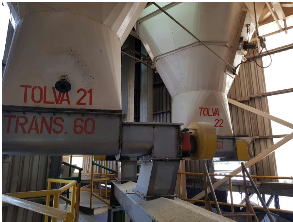
Ilustración 10 Tolvas de recibo con redirección del producto hacia transportadores.
