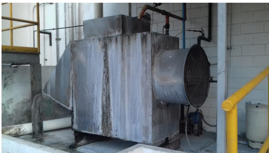
Ilustración 21 Torre de Enfriamiento, manufacturada por los técnicos de Alcon.
