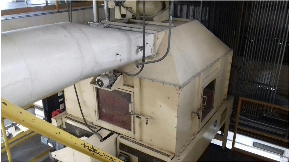
Ilustración 17 Enfriadora de producto extruido, con extractores de calor en la parte inferior.
