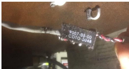
Ilustración 27 Relé marca Coto instalado
