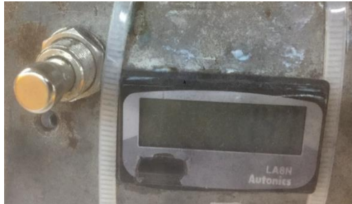
Ilustración 26 Contador autonics instalado
