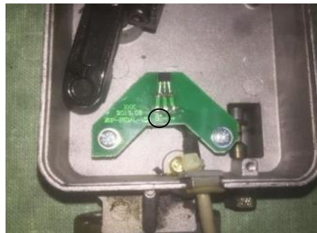
Ilustración 14 Caja de activación del motor eléctrico de la sorgeteadora
