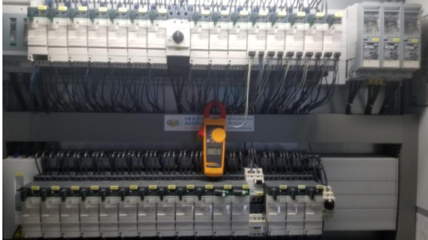
Ilustración 40-Medición corriente línea de laminado
