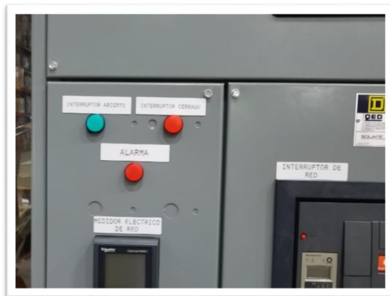
Ilustración 29 Tablero de transferencia automática 2
