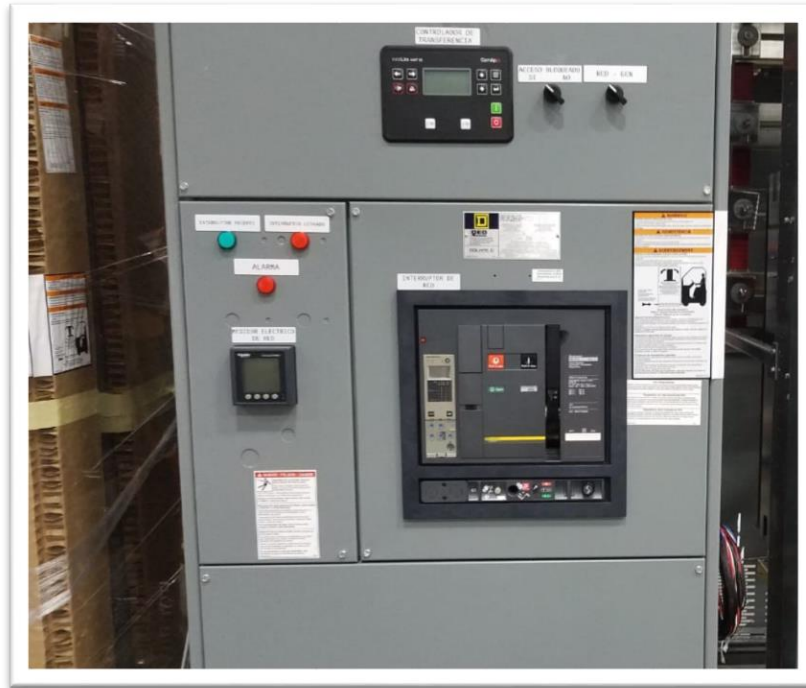
Ilustración 28 Tablero de transferencia automática 1
