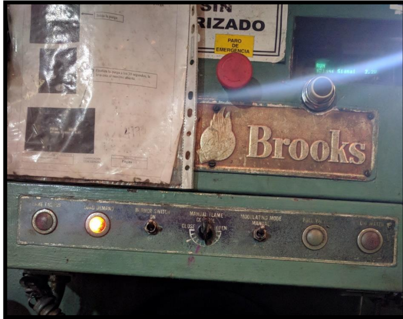
ANEXO 2. MECANISMO MANUAL DE CONTROL CALDERA #4 DE BIOGÁS
