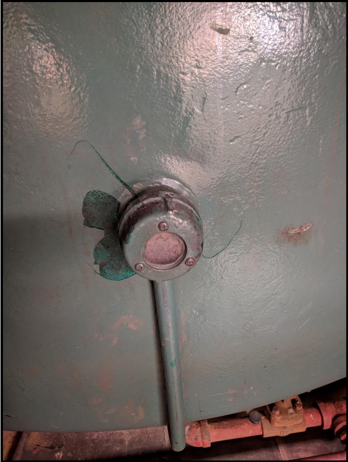
ANEXO 7. VISOR DAÑADO Y GRIETAS ANORMALES EN CALDERA #4 DE BIOGÁS
