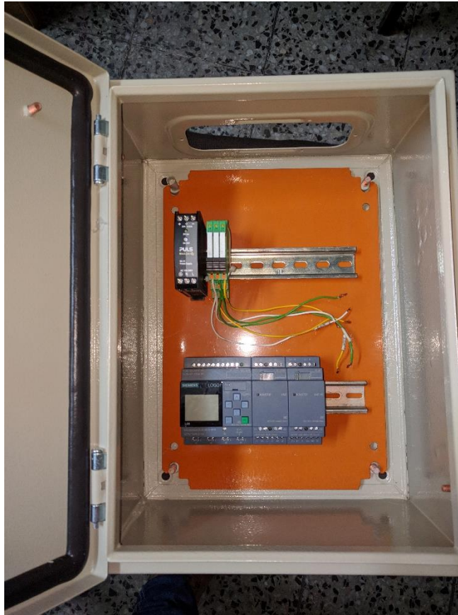
Ilustración 22 Vista de componentes existentes en caja eléctrica
