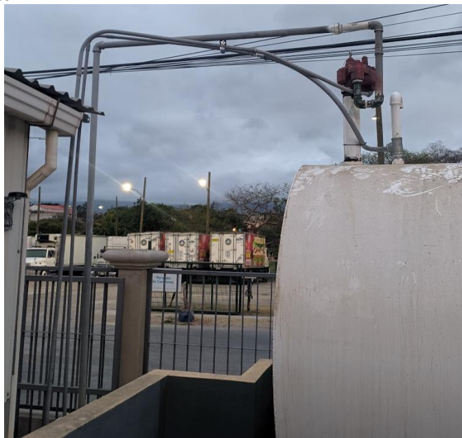
Ilustración 38-Conexion de tubería a respiradero de depósito
