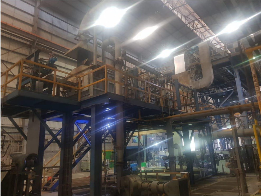
Anexo 23_ Horno y torre de enfriamiento.
