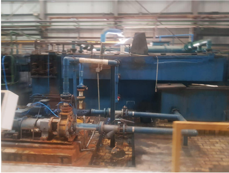
Anexo 21_Motores y componentes del acid tank.
