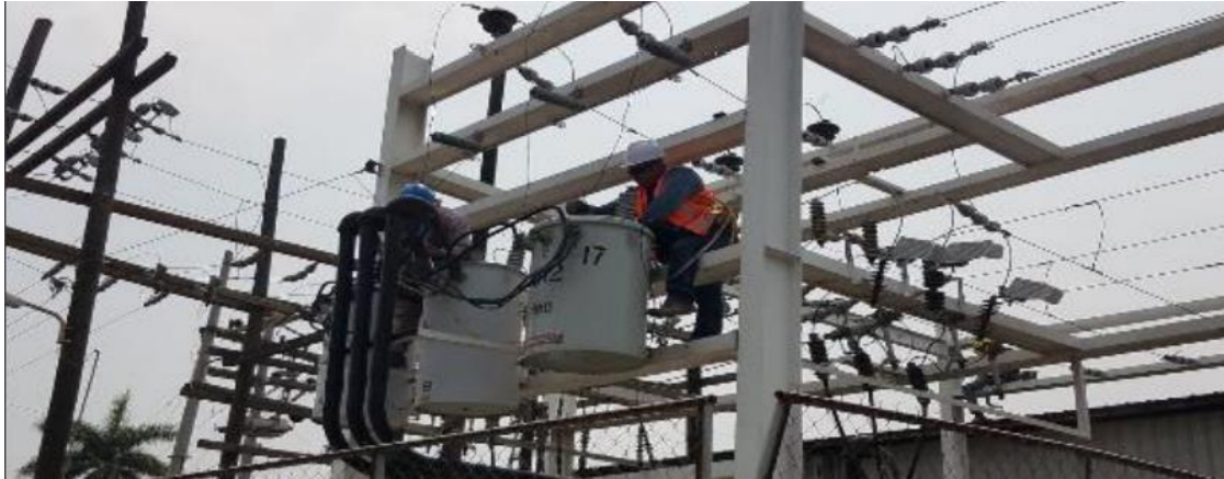
Ilustración 13 – Subestación eléctrica de grupo Jaremar
