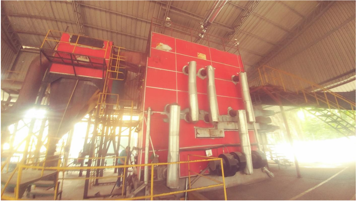
Ilustración 17 – caldera de biomasa
