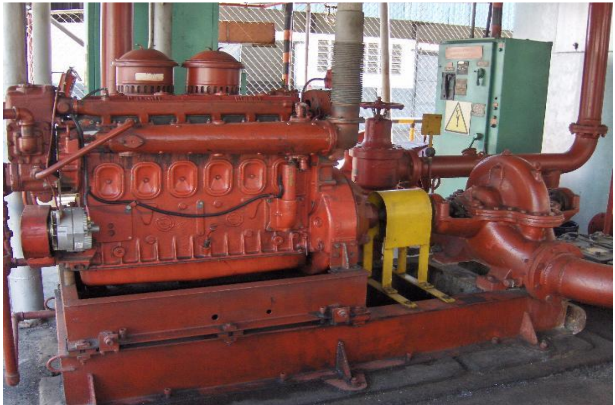
Ilustración 11 – Bomba contra incendios Caterpillar
