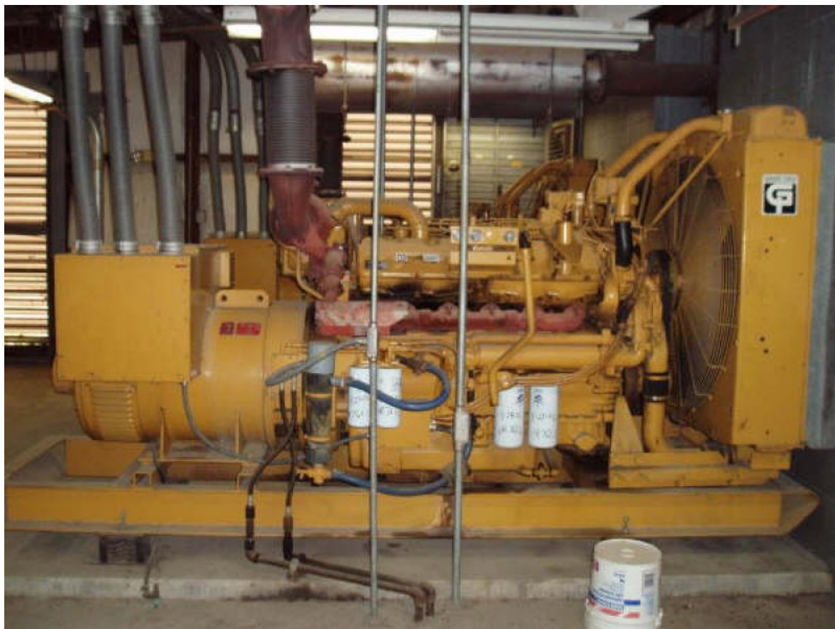
Ilustración 10 – Generador eléctrico D3412
