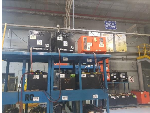
Ilustración 12. Estación de Carga de Baterías
