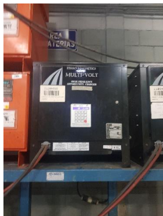
Ilustración 14. Cargador de Baterías
