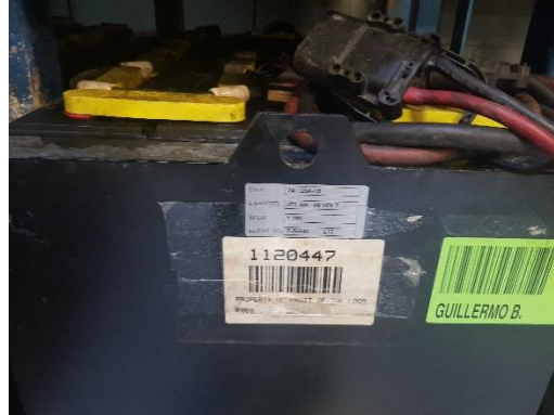
Ilustración 11. Datos de placa de Batería Industrial
