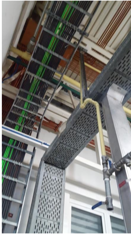
Anexo 1 - Tubería de conexión de aire comprimido
