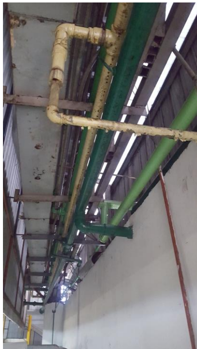
Anexo 5 - Antigua tubería de distribución de aire comprimido
