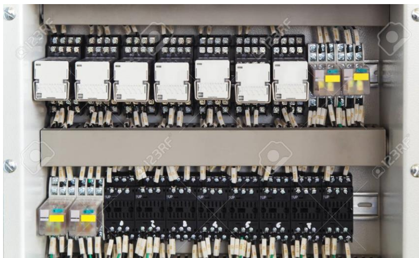
Ilustración 9: Panel de relés y cables
