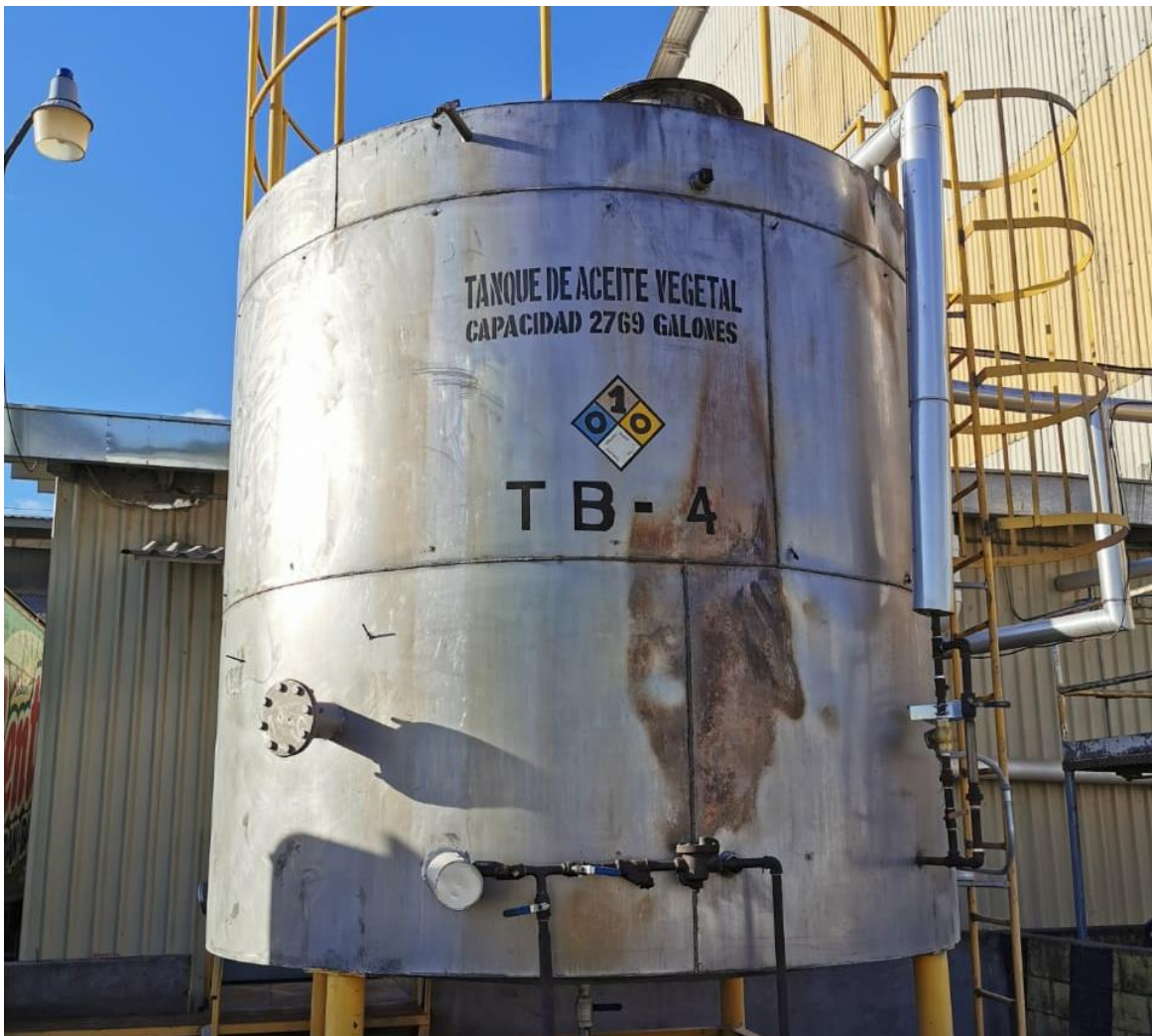
Ilustración 6-Tanque de aceite vegetal de acero inoxidable
