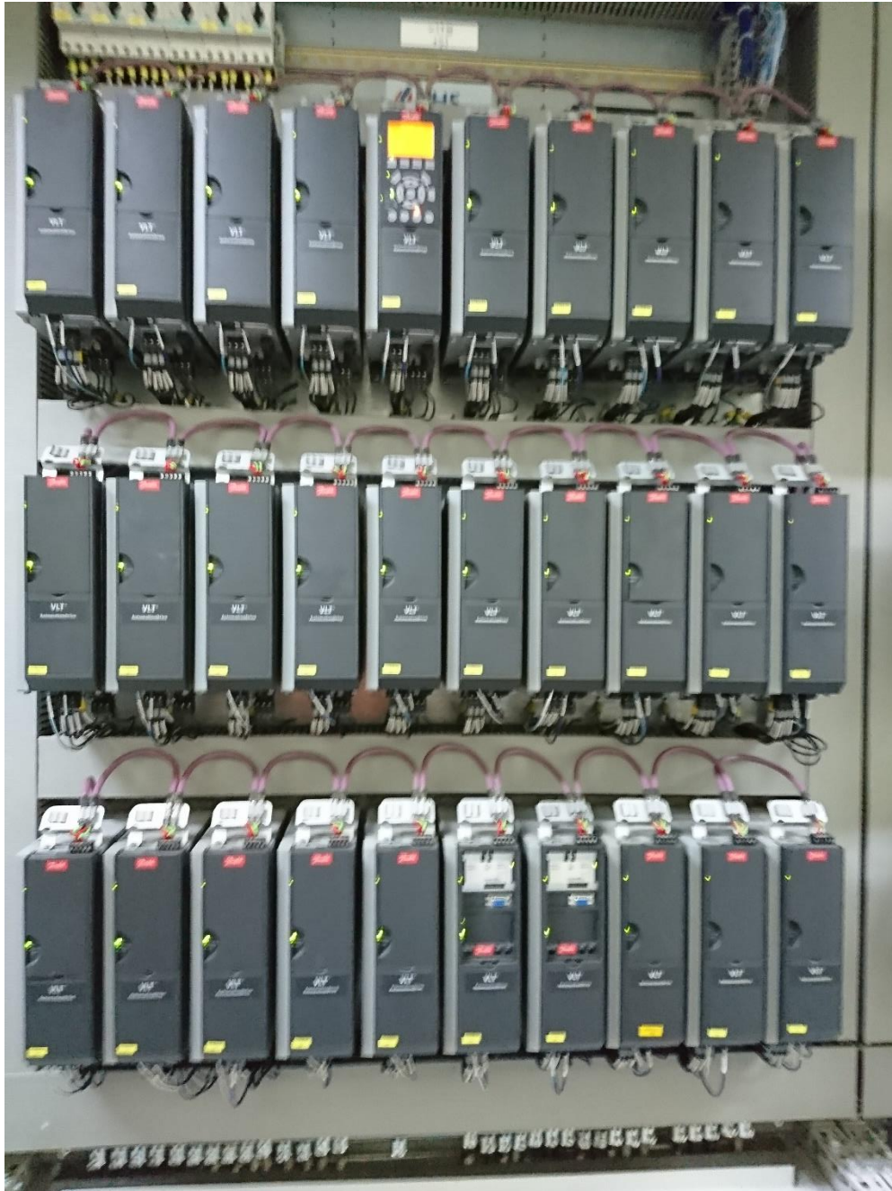
Ilustración 26. Estación de variadores Danfoss - Transporte de botellas - Línea de producción #3
