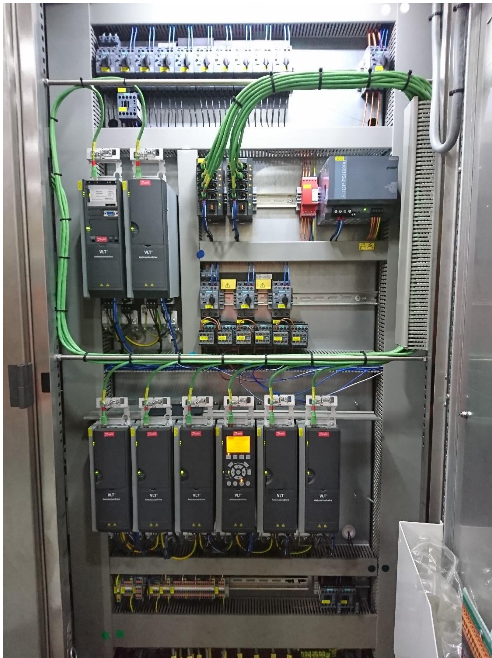
Ilustración 25. Variadores Danfoss - Transporte de botellas - Línea de producción #3
