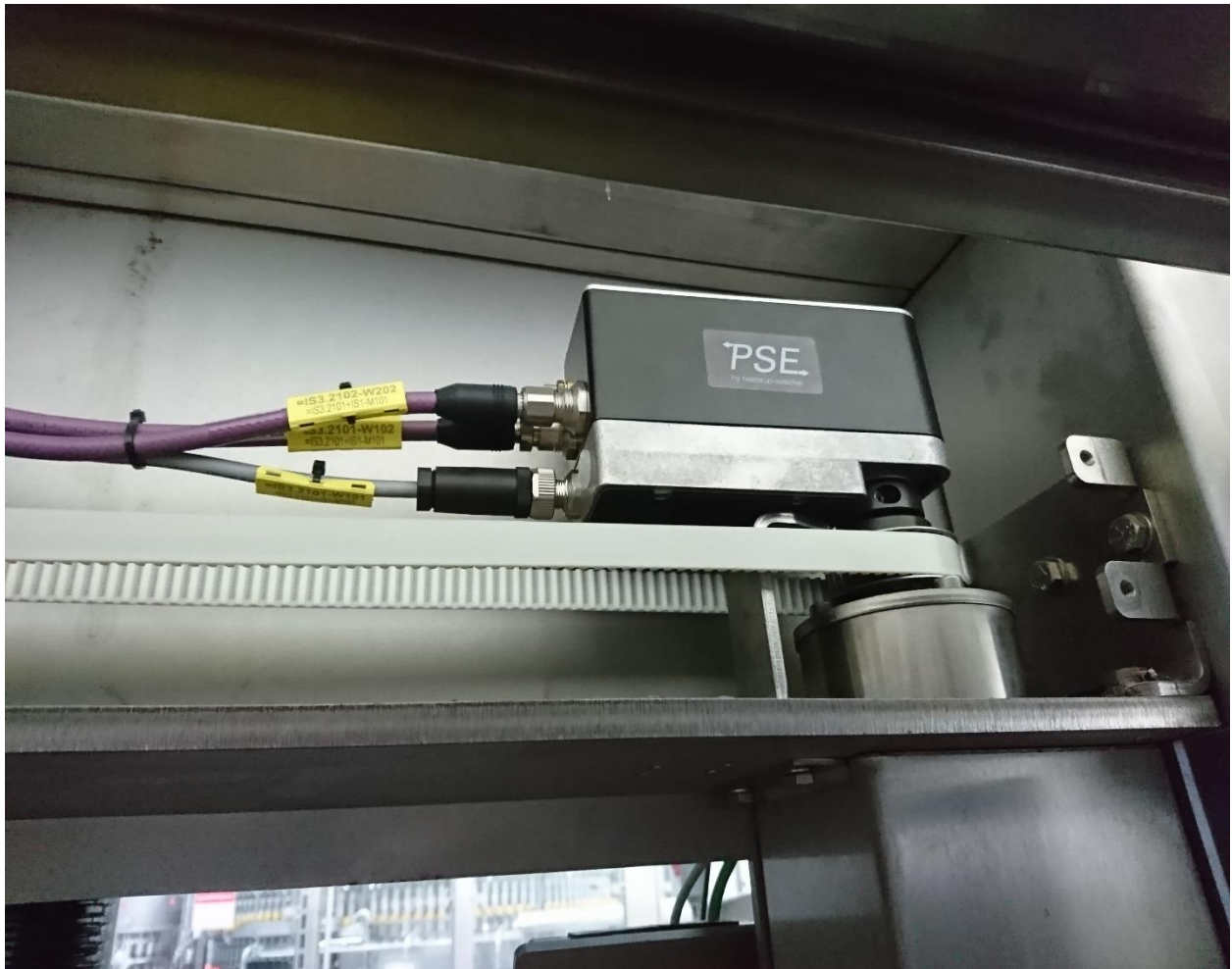
Ilustración 27. Inspección de servomotores - Linatronic - Línea de producción #3
