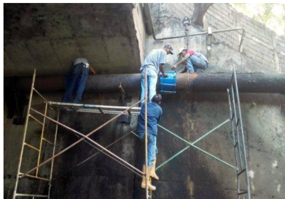
Ilustración 4 Mantenimiento correctivo por fuga de agua
