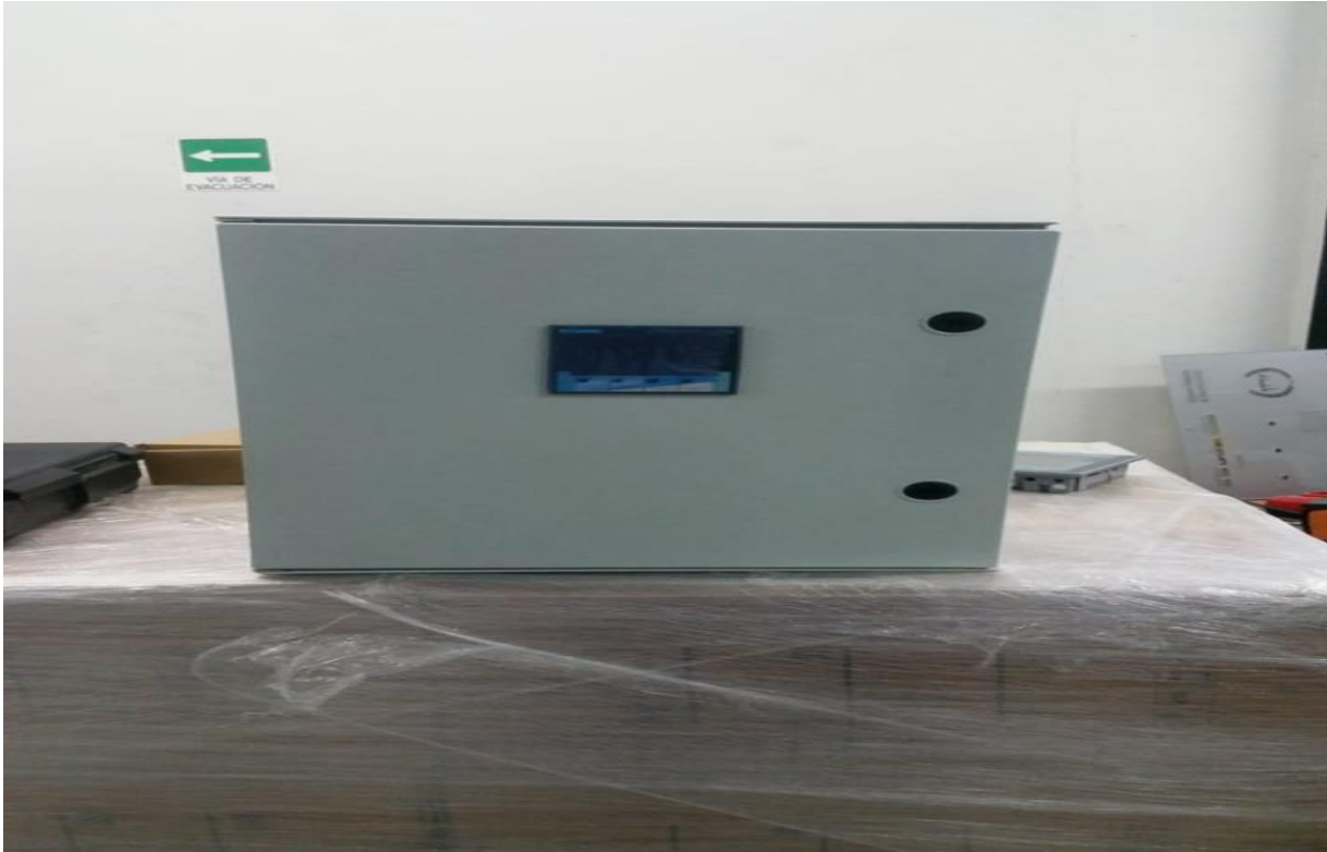
Ilustración 26: Panel Sentron Pac Exterior
