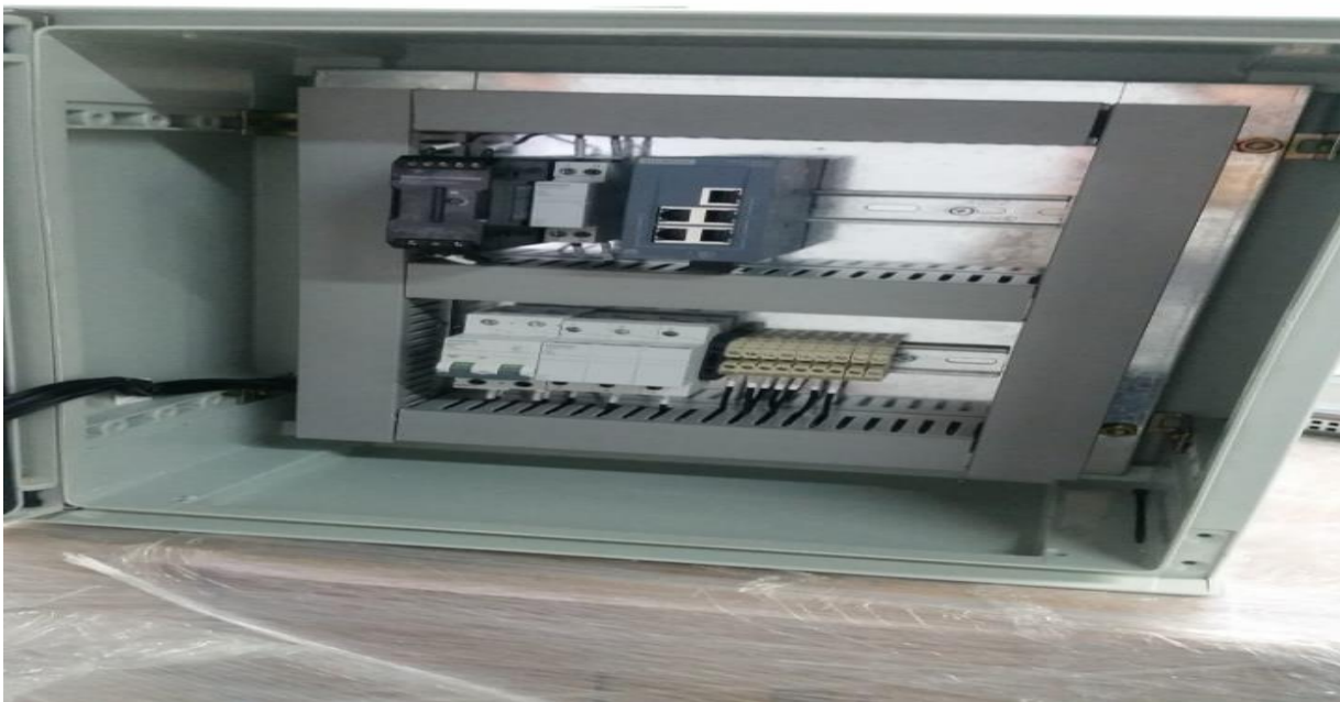
Ilustración 27: Panel Sentron Pac Interior
