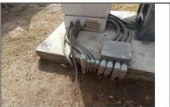
Cables 210 para puesta a tierra de BTS
