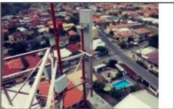
Sector 1 ModMode Antenas & RRUS instaladas
