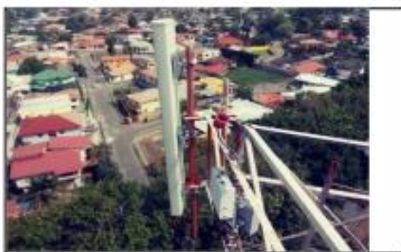
Sector 2 Modmode Antenas & RRUS instaladas
