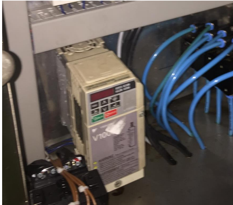
Ilustración 3: Variador de frecuencia utilizado para regular la velocidad de los motores trifásicos acoplados a las bandas transportadoras.
