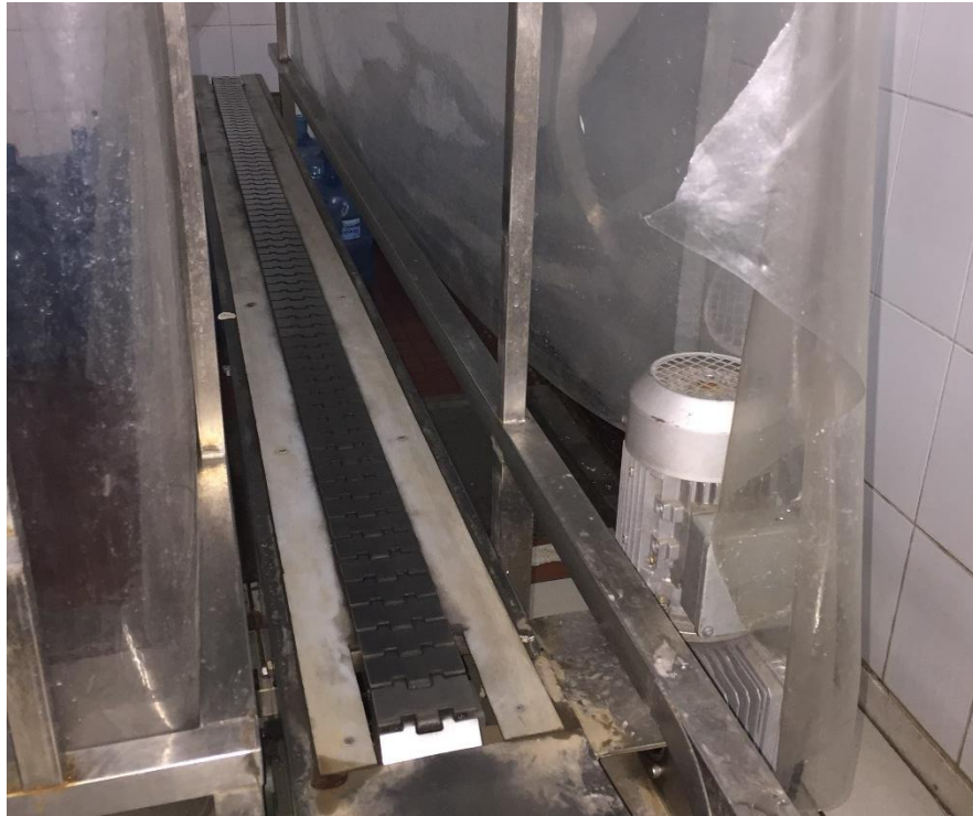
Ilustración 6: Banda transportadora utilizada para movilizar los botellones sanitizados al área de llenado
