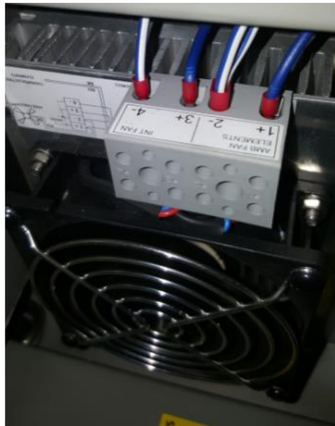
Ilustración 22. Ventiladora del inspector de botellas vacías (Linatronic línea #3)
