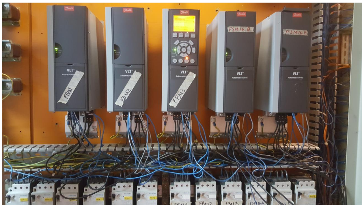
Ilustración 16. Variadores Danfoss parametrizados
