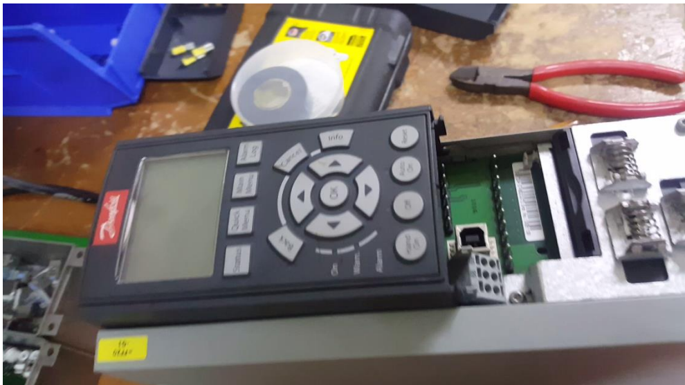
Ilustración 14. Pruebas de correcto funcionamiento de variador Danfoss
