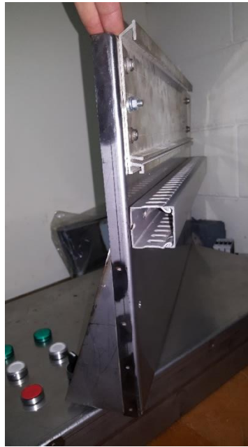
Ilustración 9. Panel superior de estación de entrenamiento PLC (rieles DIN, Canaletas, borneras y PLC)
