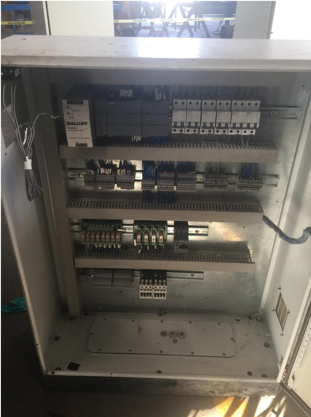
Anexos 4 Instalación completa de panel para pruebas de instrumentos
