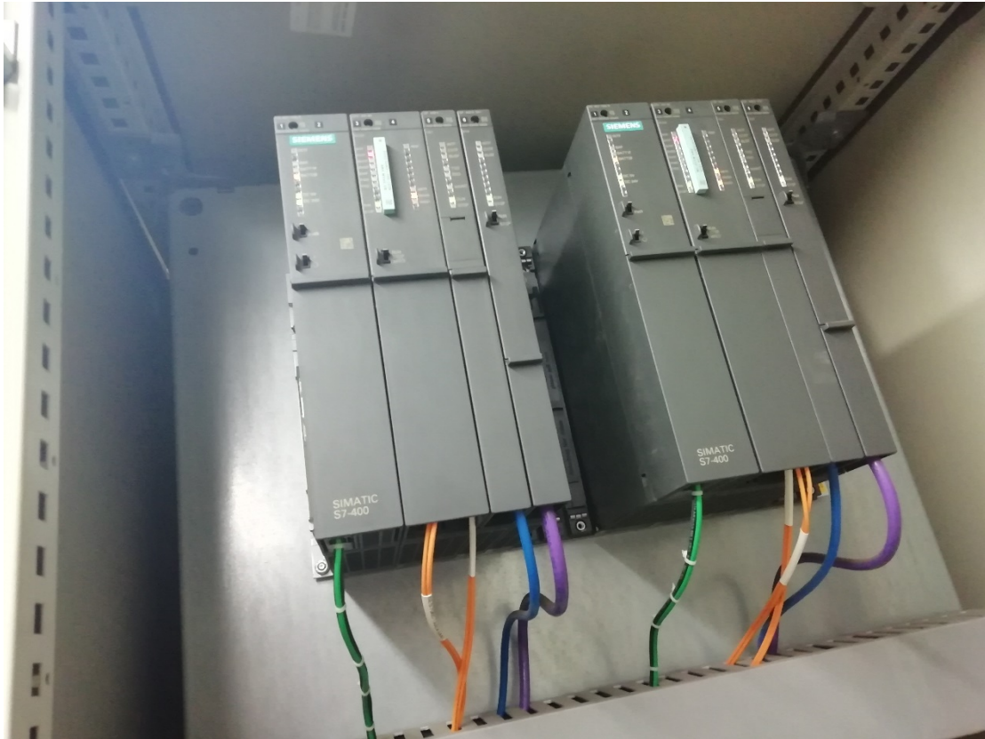
Ilustración 13. PLC S7-400 con sistema redundante como sistema de control de la caldera de AZUNOSA
