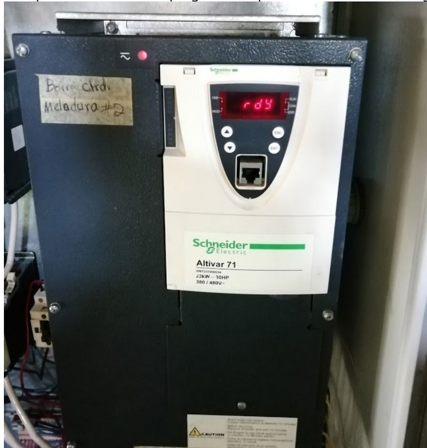
Ilustración 6. Variador de velocidad marca Schneider.
