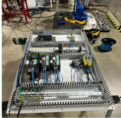
Ilustración 87. Panel eléctrico finalizado.
