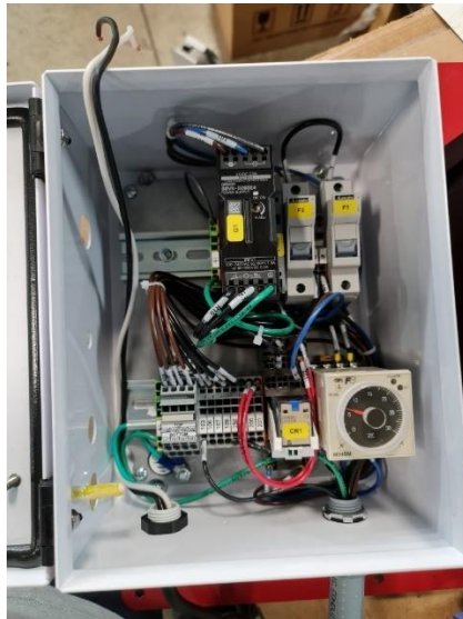
Ilustración 48. Caja de Control para Túnel de Agua.
