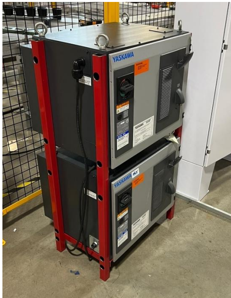
Ilustración 118. Montaje de los controladores del robot.
