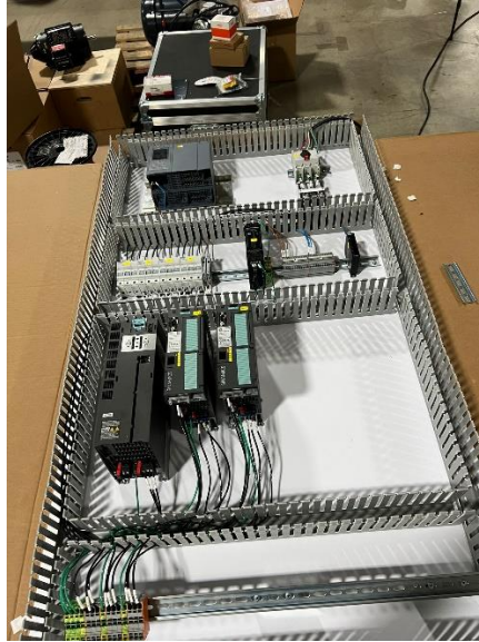
Ilustración 86. Cableado del Panel.
