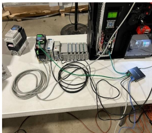
Ilustración 78. Conexión de equipo Allen-Bradley.
