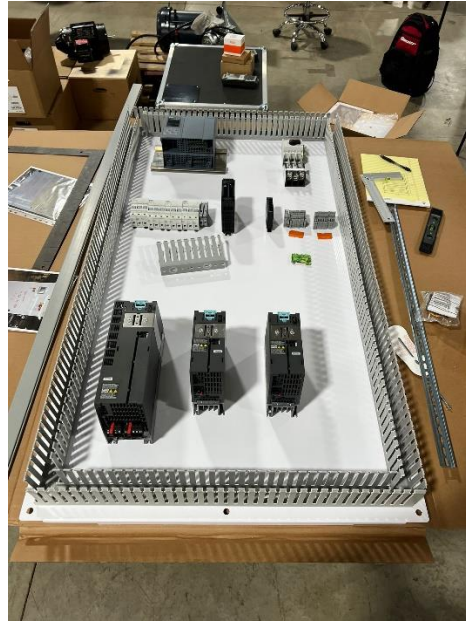
Ilustración 84. Componentes del Panel Eléctrico.
