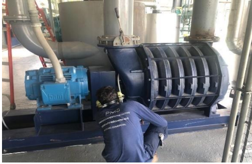
Ilustración 32. Turbina de 125 HP
