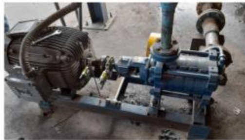
Figura 1: BOMBA AUXILIAR CALDERA VR
