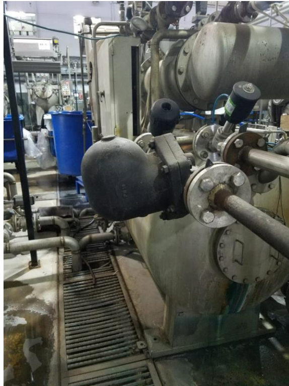
Ilustración 20 Trampas de vapor.
