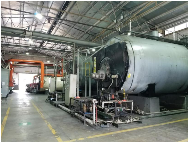
Ilustración 11 Área de Calderas.
