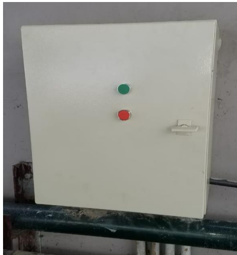
Ilustración 19 Panel de control en la estación de bunker.
