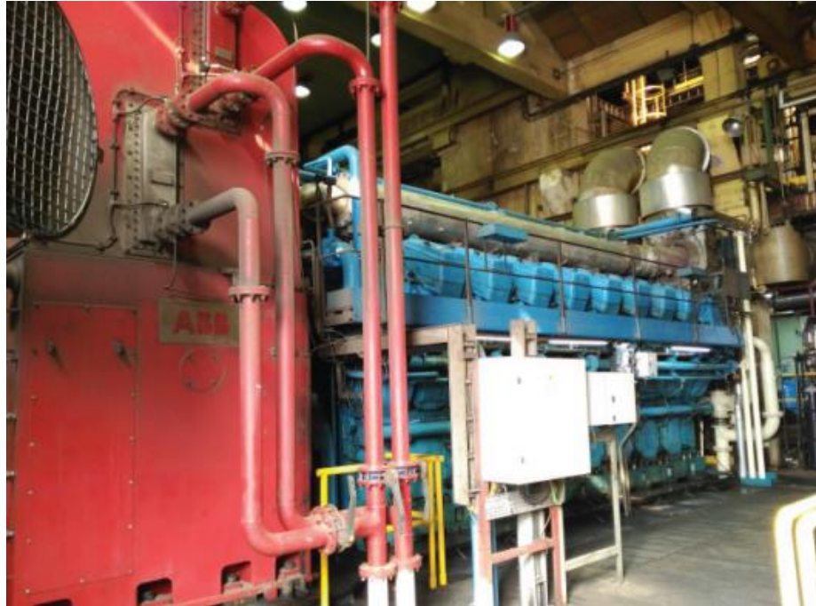
Ilustración 4 Generador industrial Diesel
