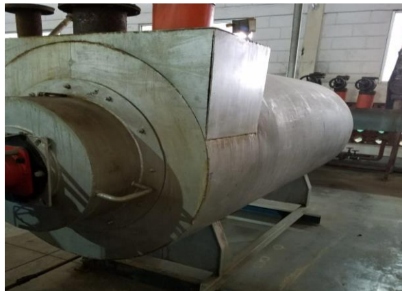
Ilustración 15 Caldera de vapor.
