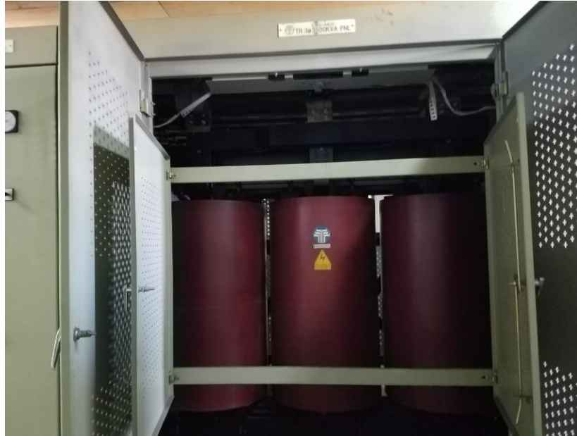
Ilustración 22 Transformador de 3300 KVA
