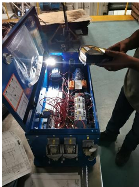
Ilustración 20: Nuevo Panel Marca ABUS Para Movimiento Norte/Sur del Polipasto
