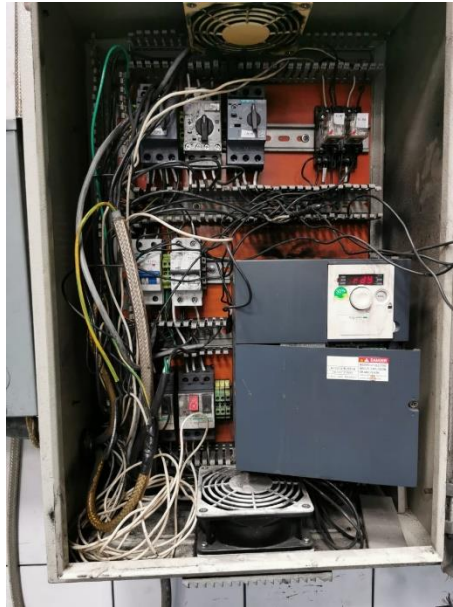
Ilustración 18: Panel de Movimiento Norte/Sur de Polipasto a Cambiar
