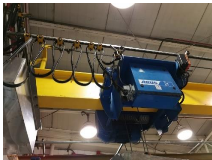
Ilustración 14: Sistema de Grúa con Polipasto ABUS
