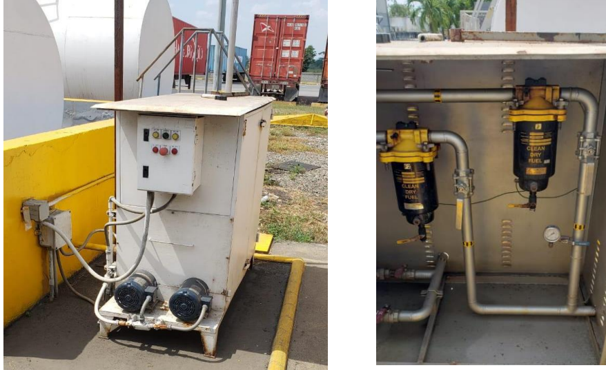
Ilustración 22 Sistema de Bombeo de Diesel
