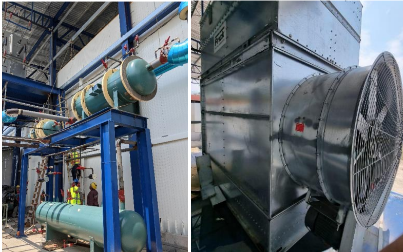
Ilustración 27 Cuarto de compresores y condensador.
