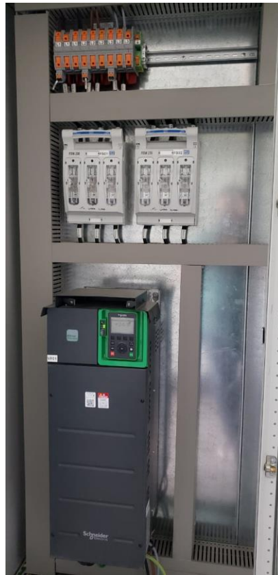
Ilustración 47 Variadores de Frecuencia en Sala de control de Bombas
