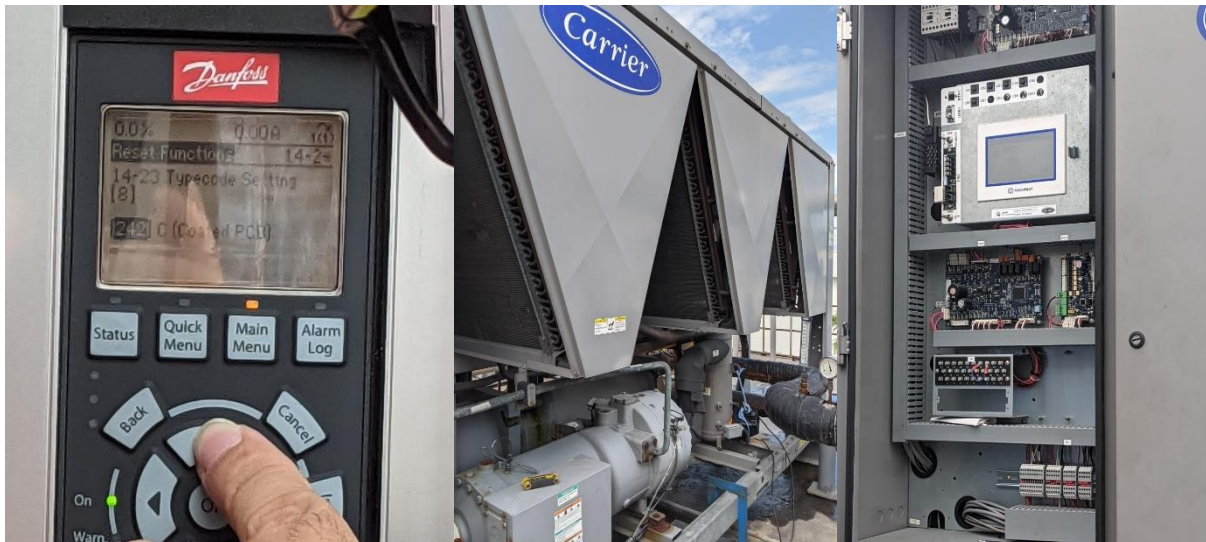
Ilustración 38 Chiller en Elcatex.
