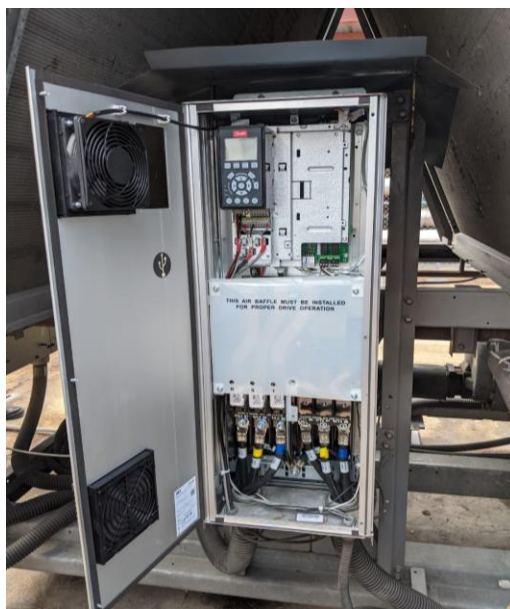
Ilustración 31 Variador de Frecuencia en ELCATEX
