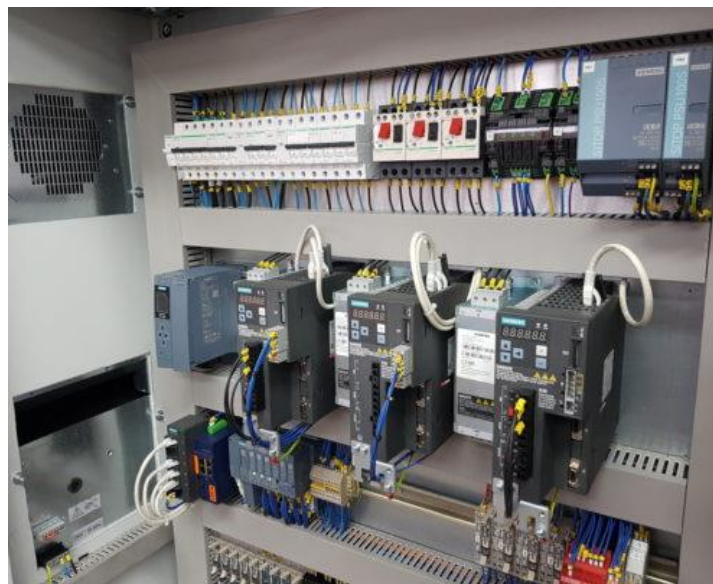
Ilustración 3: PLC y tablero de control
