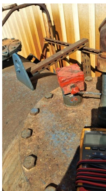
Ilustración 38 Convertidor de nivel en cortocircuito
