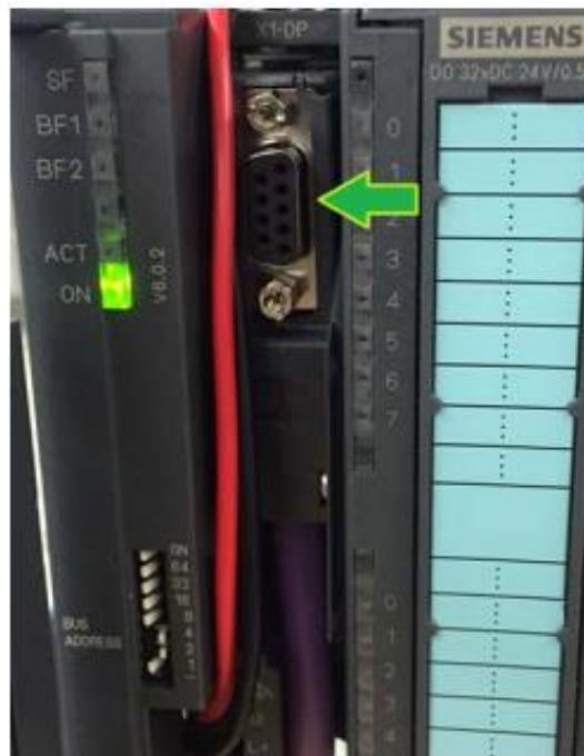
Ilustración 9 SIMATIC ET200M Profibus puerto de diagnóstico de esclavo
