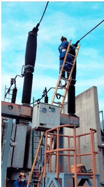
Ilustración 36 Desconexión de energía de transformador
