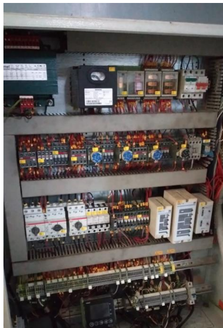
Ilustración 14 Panel de caldera auxiliar
